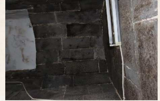
صورة ١ : تأثر جدران سلم السطوح بالرطوبة
