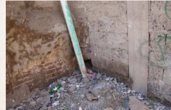
صورة ٧ : المجاري من أسباب الرطوبة في الجهة الشرقية
