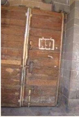
صورة ٣ : الباب الخشبي بحاجة إلى ترميم
