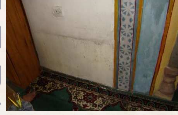
صورة ٤ : الرطوبة على الجدار الشمالي لبيت الصلاة
