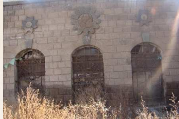
صورة ٢ : تشققات على جدران ونوافذ وزخارف الضريح الجنوبي
